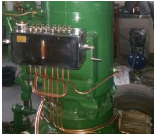
15.Ny oljepumpe med røropplegg
