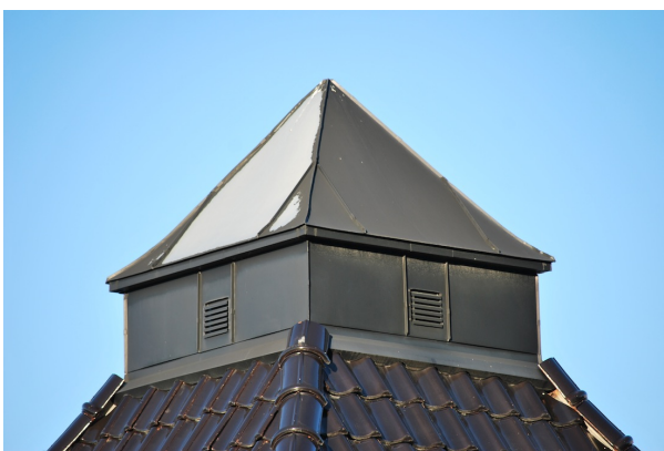
Båndteking, Plastbelagt stål, Trafokiosk
