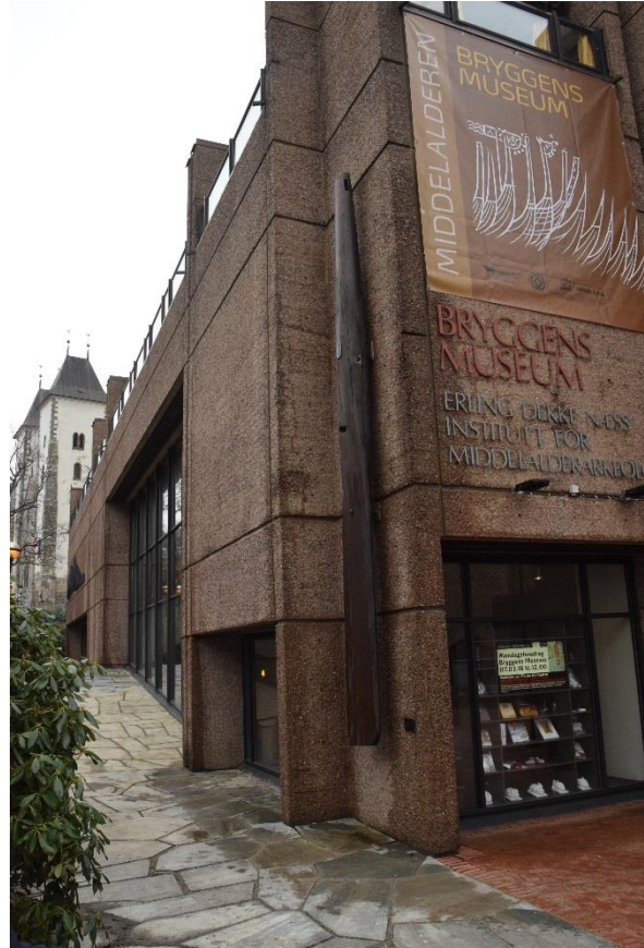
Armeringa i fasaden til den prisvinnande bygningen til Bryggens museum rustar og sprengjer seg ut gjennom betongelementa i fasaden.
