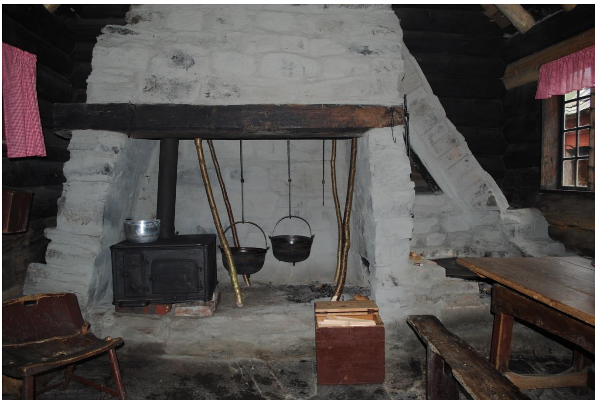
Grua i eldhuset i Viga, Hjelmeland, etter oppattmuring med leirmørtel. Til høgre for grua eldstad for takke. Foto: Grete Holmboe, Ryfylkemuseet.
