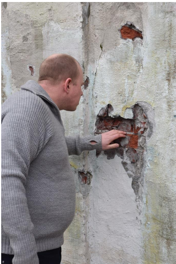
Sementpuss på kalkpuss på Gamle Bergen museum. Anders Dragesund inspiserer elendet.
