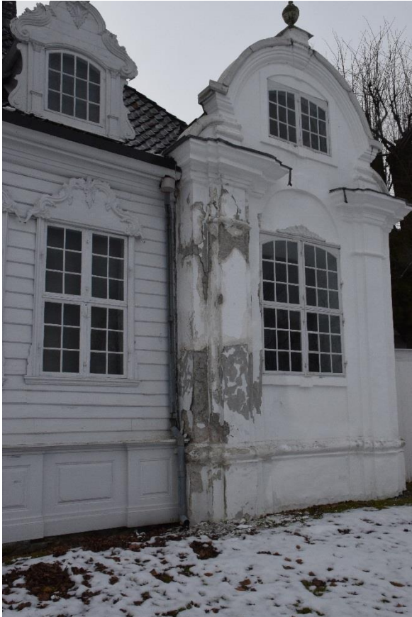
Damsgård Hovedgård har pussa pilastrer i hovudfasaden. Dei er ei kjelde til stadig bekymring for dagens forvaltarar.
