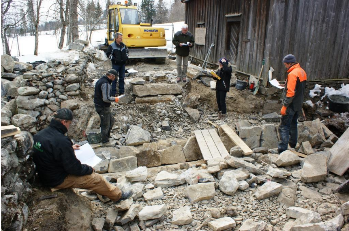
For å sikre god avrenning har Mjøsmuseet restaurert kulverten under vegen inn til hovudtunet på Stenberg.
