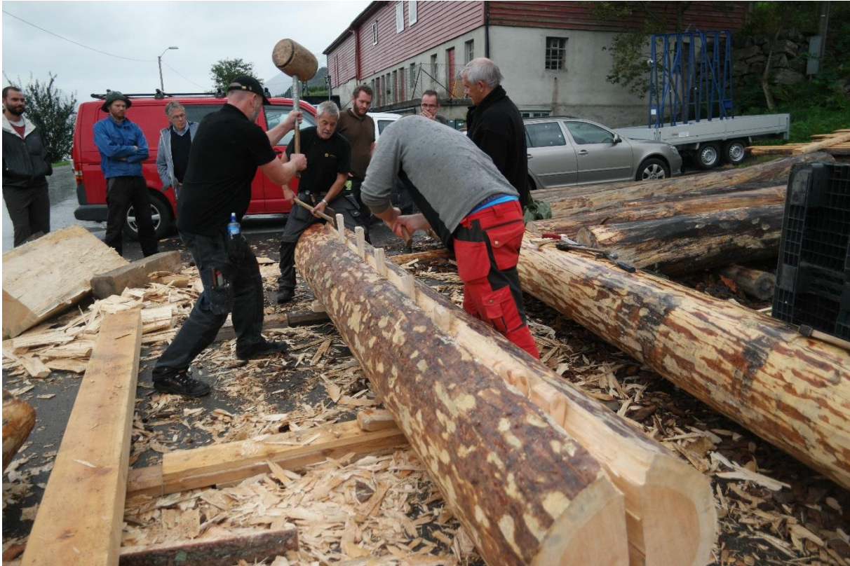
Vedlikehald, reparasjon og vern er gode miljøtiltak. Frå Agatunet hausten 2015. Foto: Hardanger og Voss museum.
