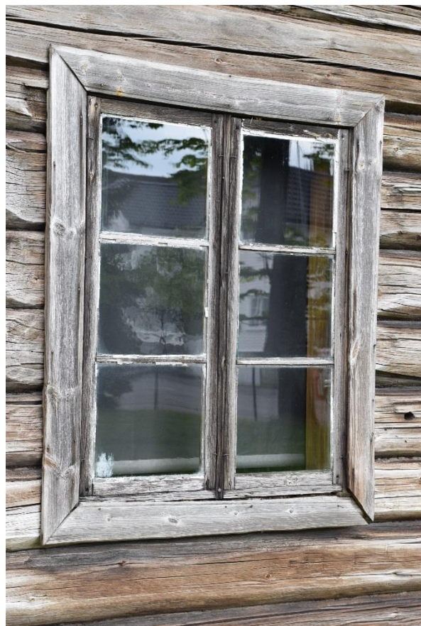
Det er gamle syndar som gjer at det snart ikkje er kittfals att i glasa. Dei var nok opphavleg måla, men på museet har dei stått umåla sidan huset kom dit.
