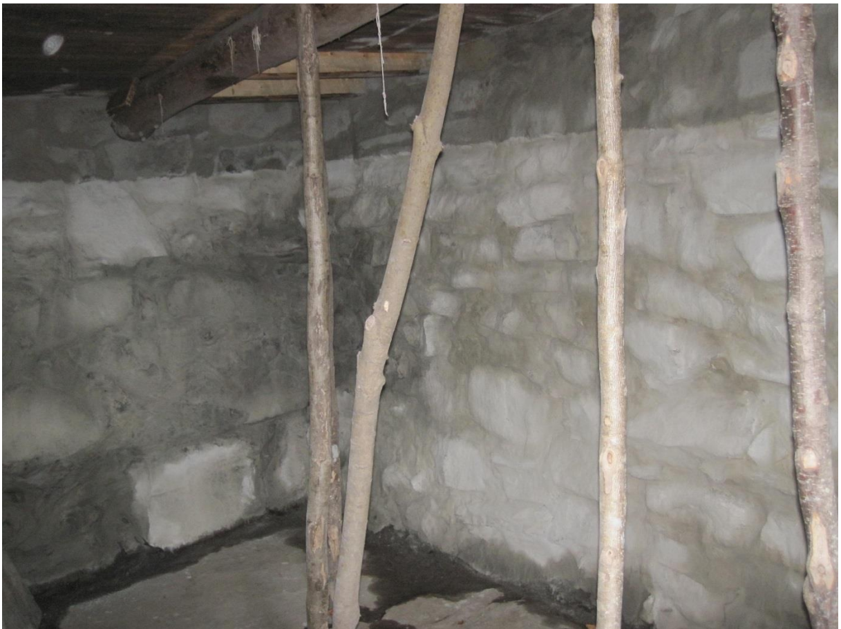
Kjellaren i hovudbygningen i Viga sto full av vatn kvar gong det regna etter at ei gammel dreneringsgrøft var kjørt i fyller av tunge landbruksmaskiner. Etter oppattaking av dreneringa har museet fått eit tørt og fint kjellarrom som på det nedste bildet er pussa med kalk. Foto: Ryfylkemuseet.
