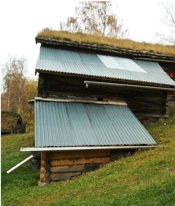
Hønsehuset på Øygarden, Maihaugen, var impregnerert med Bernakre. Nå er det meste av tømmeret erstatta med nytt, og det er lagt bølgeblikk over.
