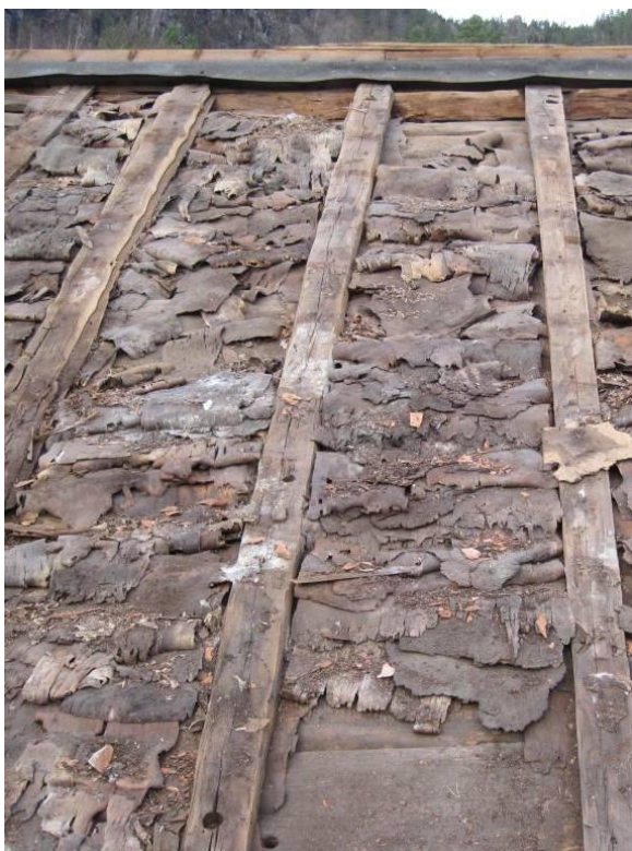
På løetaket på Kolbeinstveit i Suldal var det never under pannene på eine sida og flis på andre sida. Foto: Ryfylkemuseet.
