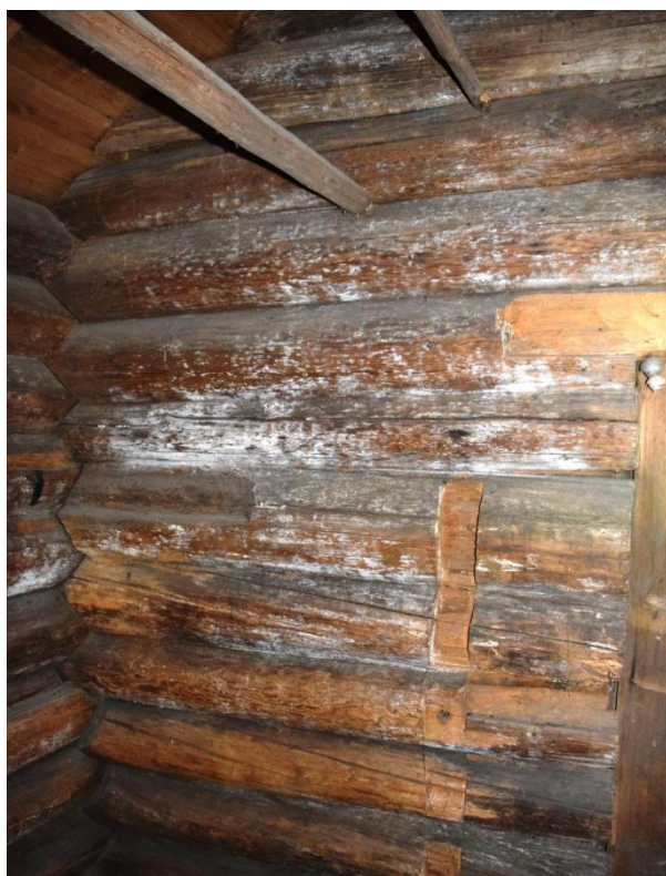
Mangel på balansert ventilasjon har ført til urovekkande vekst av muggsopp i eit loft på Telemark museum. Kanhende er taktekkinga med plast under torva eit av problema.
