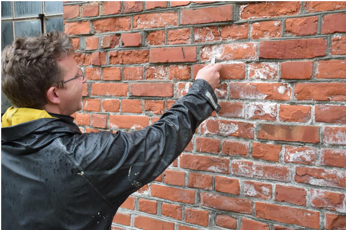
Morten Hjarnø viser korleis soda viser att som saltutslag, bind funkt i veggen og fører til frostsprenging i stort omfang.
