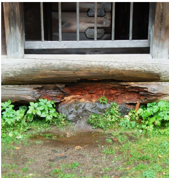
Dryppskader er ei kjelde til store bekymringar og omfattande vedlikehaldsarbeid på Folkemuseet.
