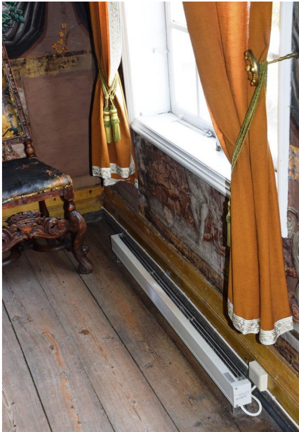
Klimastyring ved hjelp av panelomnar på Damsgård.
