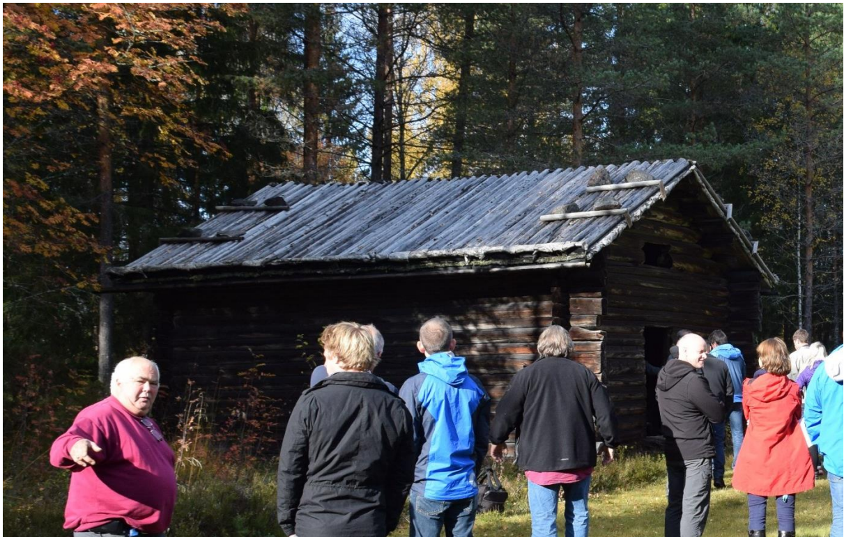
Badstova på Finnetunet på Glomdalsmuseet har tak med halvkløyvingar som ytre dekke. Eit fuktigare klima og tett skog kring bygningen skaper utfordringar for vedlikehaldet.
