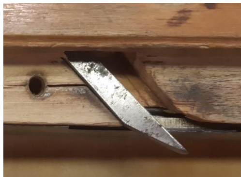
BILDE 7 SPREKK I HØVELSENG (A)
