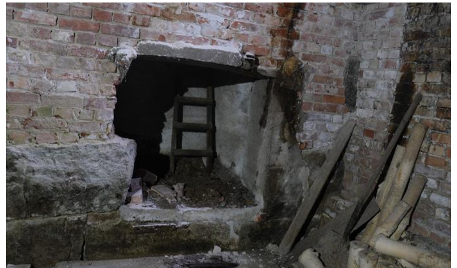
Fra vegg mot Hoggeriet som har betydelige forvitringsskader.
