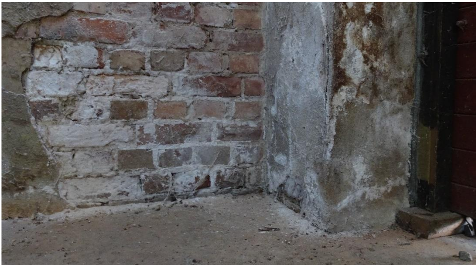
Skader etter salt- og frostforvitring i vegger nederst i hjørne mot sørvest.
