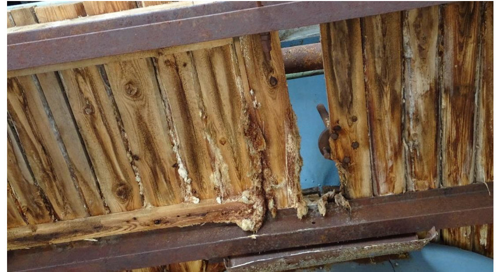
Lutråte i golv ved en av koketankene, med manglende planke.
