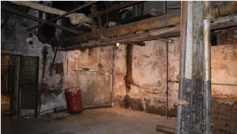
Fra Turbinhallen sett mot vegger til Papirmaskinsalen, Kokeriet og Hoggeriet, vegger med betydelig salt- og frostforvitring.
