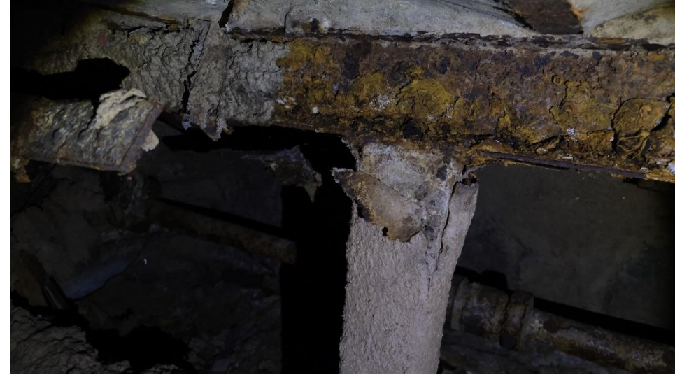
Situasjon like innenfor luke vist i forrige bilde. Det er store rustskader i stål som bærer golvet over kjelleren, i bjelke og søyle.
