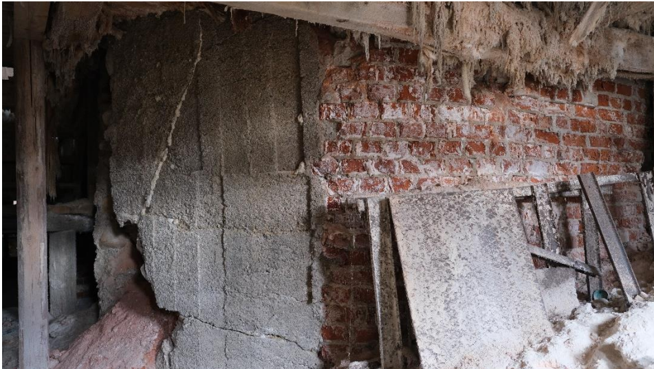
Sterkt skadet fundament under søndre miksekar, bl.a. er påstøp som skulle sikre fundamentet ødelagt av salt- og frostforvitring.
