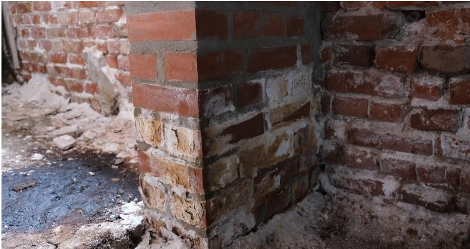
Fra vestvegg ved åpning til motorrom. Det er omfattende saltforvitring i gammel og ny tegl.
