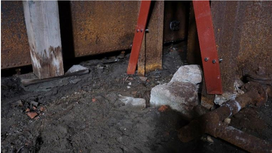
Fuktig grunn i kjelleren i vestre del av bygningen. Betongfundamenter har forvitret, det er korrosjonsskader i stål og råteskader i trevirke.
