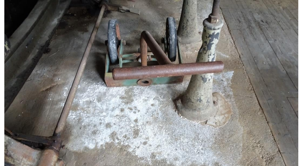
Betonggolv ved arkkutter i første etasje med saltutfellinginger. I tillegg en del stål med overflaterust.
