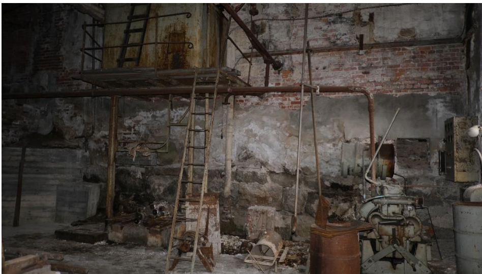
Nedre og søndre deler av vestvegg sett fra Fyrhuset. Veggen har alvorlige skader pga. salt- og frostforvitring.
