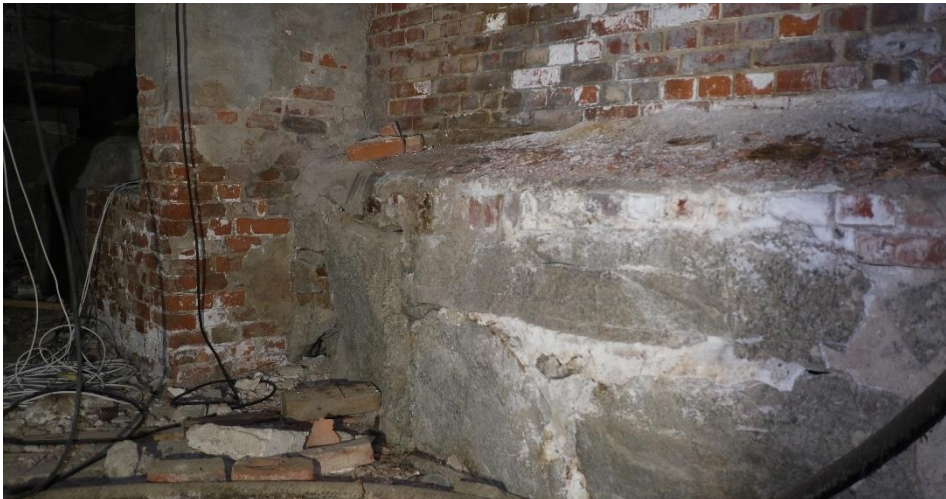
Typisk situasjon ved vegg til Kokeriet, salt- og frostforvitring i teglmurverk, inkl. Tegl på grunnmurkrone og tegl eller mørtel i fuger mellom naturstein.
