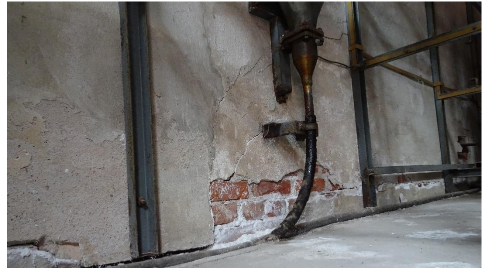
Parti av golv og delevegg i traferommet. Salt- og frostforvitring har ført til sprekker og bom i sementpuss på vegg.
