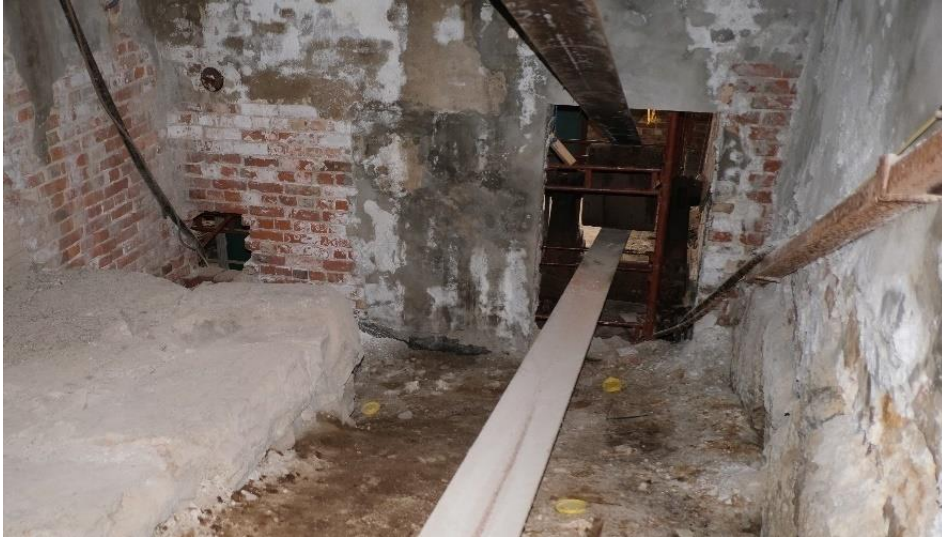
Fra vestre ende i Remkanalen, fuktig grunn og omfattende salt- og frostforvitring i vegger. Til høyre åpning til maskinrommet.
