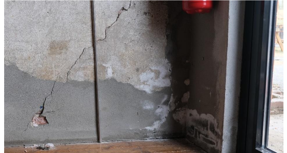
Ved innerliv er det godt synlige skader i puss, sprekker og saltutslag.
