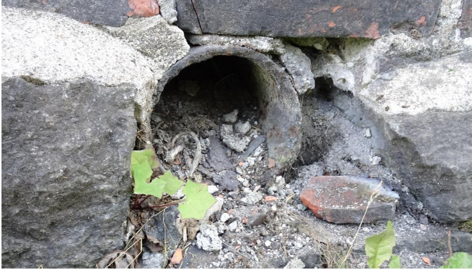
Eksempel på lufterør i støpejern gjennom grunnmur som delvis er tettet med diverse løsmasser, her fra vestsiden av bygningen.
