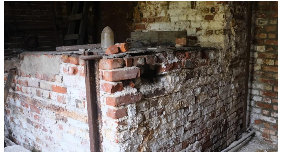
Massiv saltforvitring i ovnsfundament ved nordøstre hjørne.
