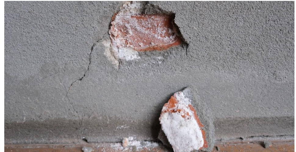
Utsnitt av samme bilde som over. Salt som krystalliserer på tegl har sprengt slik at puss løsner.
