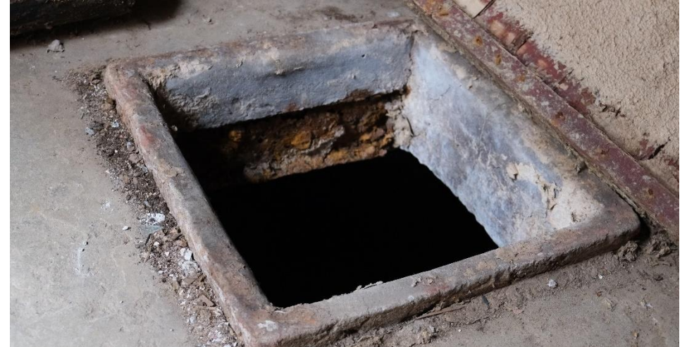
Fra luke i golv der steget i stålbjelken inntil åpningen har gjennomgående rustskader.
