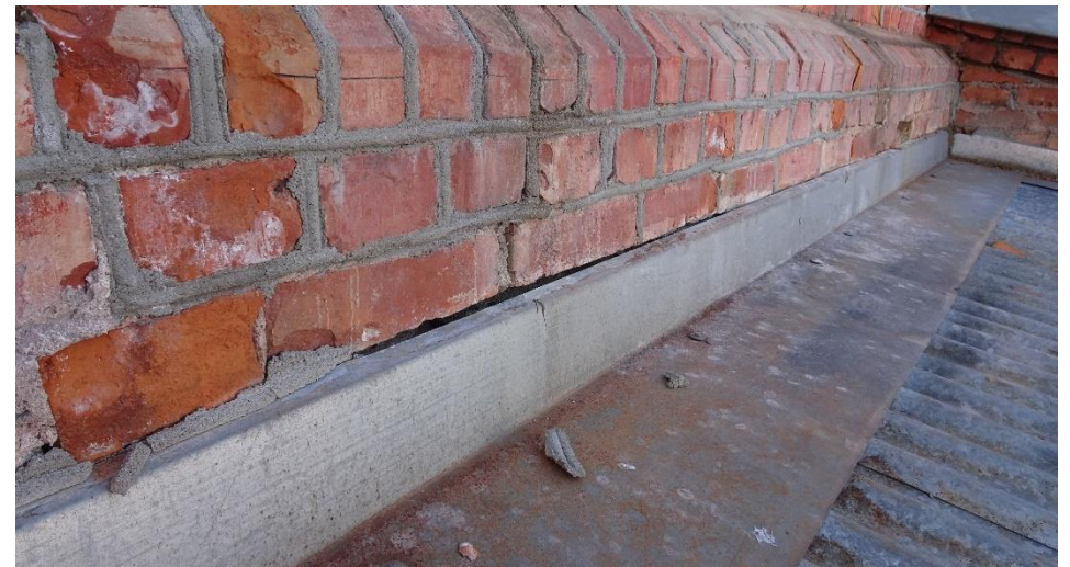
Parti av taktekingen mot vestvegg til Kokeriet der det bygningstekniske løsninger som ikke fungerer og små lekkasjer.
