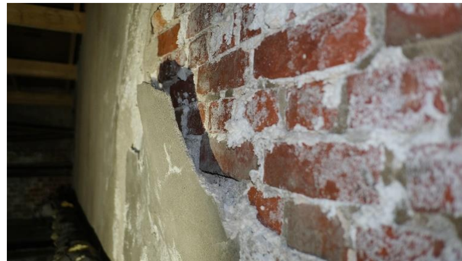
Fra samme del av sørvegg mot Remkanalen. Sementpuss som sprekker opp og flaker av som følge av salt- og frostforvitring.
