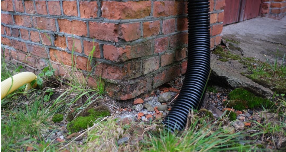
Terreng som står høyt på hjørne mot sørøst, samtidig vann fra taknedløp, med store forvitringsskader i et avgrenset parti som resultat.
