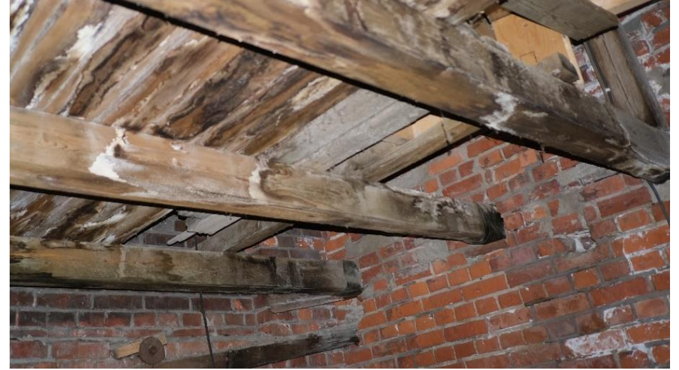
Fra østre ende i kanalen med deler av golv i gangen mellom Kokeriet og Luthuset. Det er fuktskader i bjelker og i borddekke.
