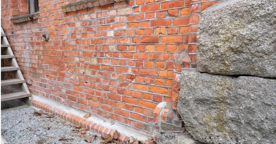
Fra hjørne mot sørøst. Eksempel på parti av yttermur som har betydelige forvitringsskader i tegl og dels i fuger. Tegl trekker til seg fukt, blir utsatt for frost og sprekker opp, som tynne flak eller i større deler.
