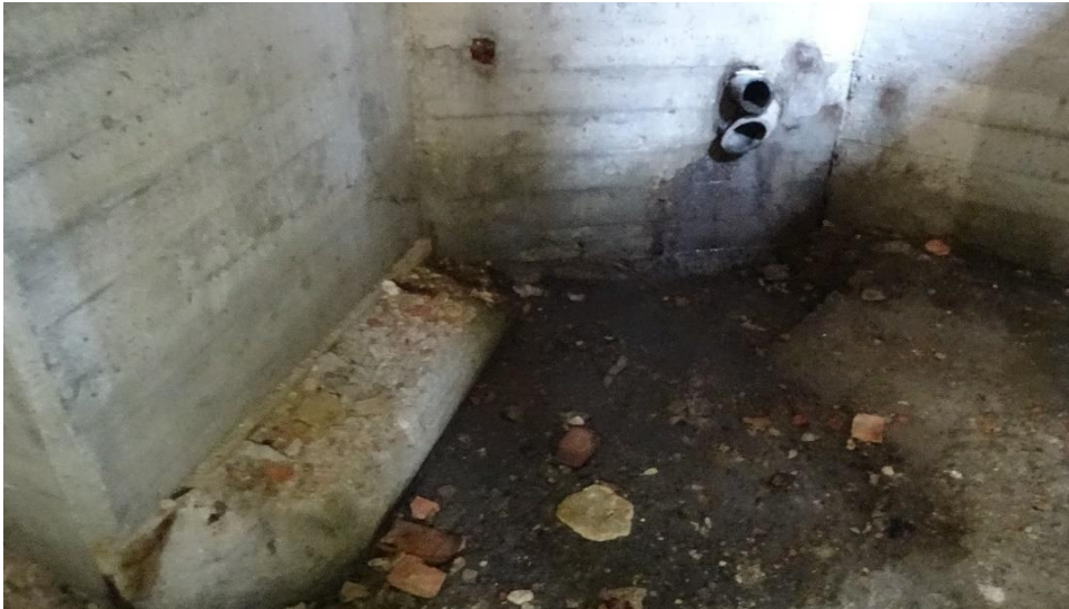
Fuktig grunn i nordøstre hjørne i kjeller, ved enden av drenerør.
