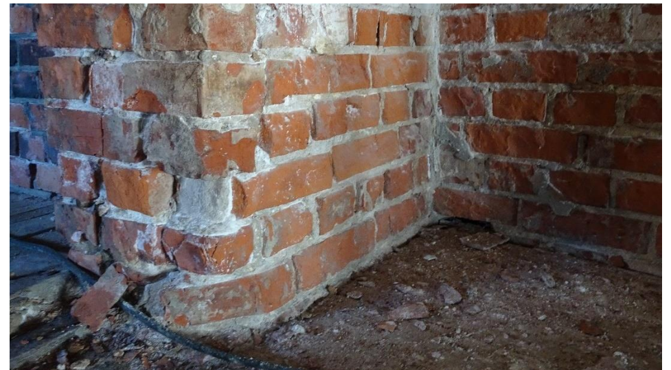
Fra hjørne mot nordøst, nedre del av døråpningen til Remkanalen. Ganske store skader i teglvegger etter salt- og frostforvitring.
