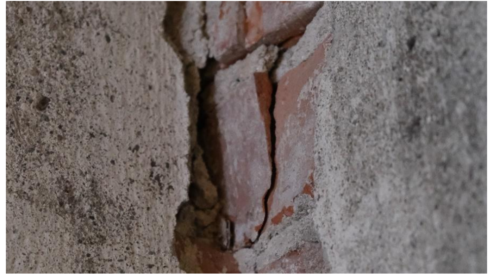
Eksempel på andre skader i teglvegger, her fra hjørne innvendig i sørvest (mot Kokeriet).
