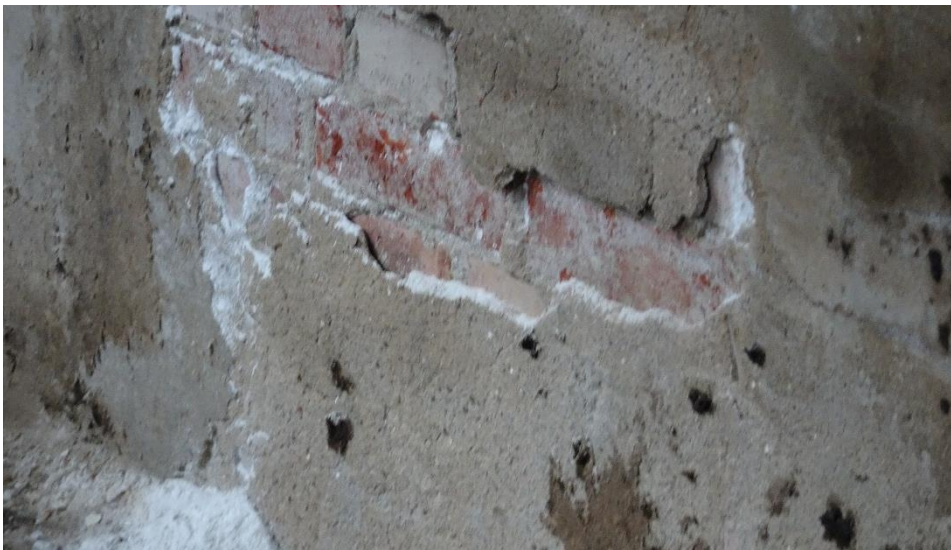
Typisk situasjon ved innerliv til nordvegg med salt som krystalliserer og sprenger slik at sementpuss mister heft.
