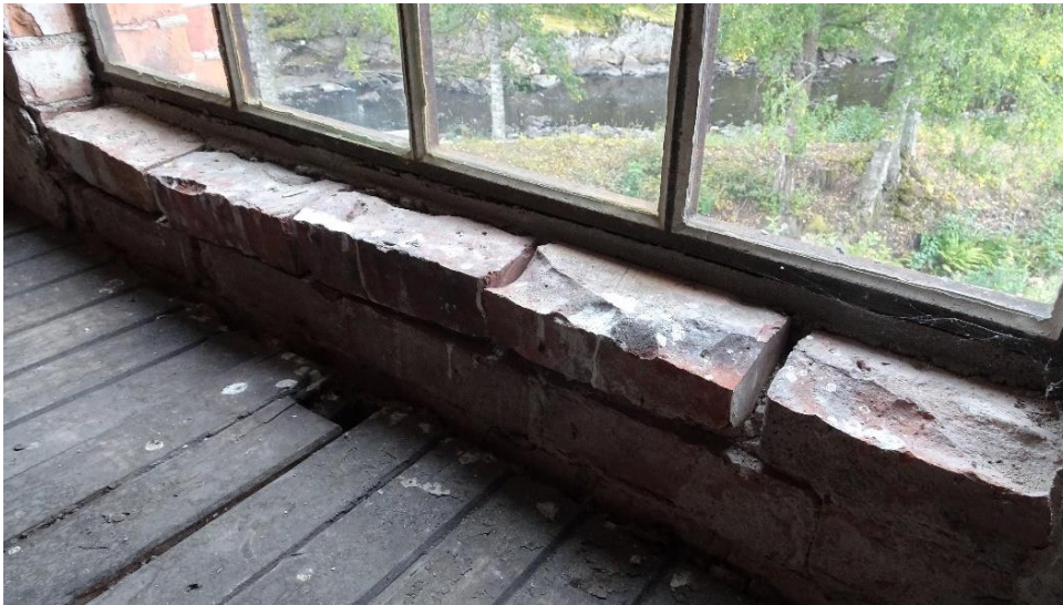
Ved vindu i andre etasje i vestvegg. Som følge av kondens på glassruter og frost har puss løsnet og fuger forvitret så mye at stein ligger uten heft.
