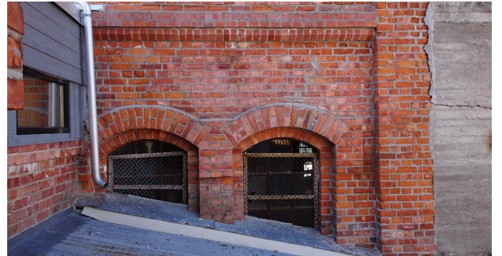
Eksempel på parti av taktekingen der det er lekkasjer i kanter mot vegg til Kokeriet.
