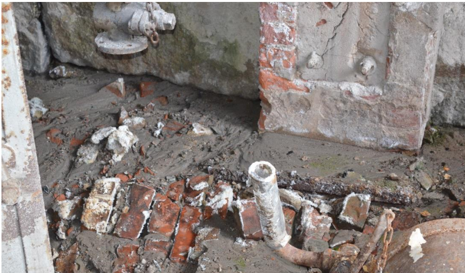
Slam på golv ved vegg mot Luthuset i september 2020 etter kraftig regnvær. Slammet trakk fra luthuskjelleren og inn i Fyrhuset.
