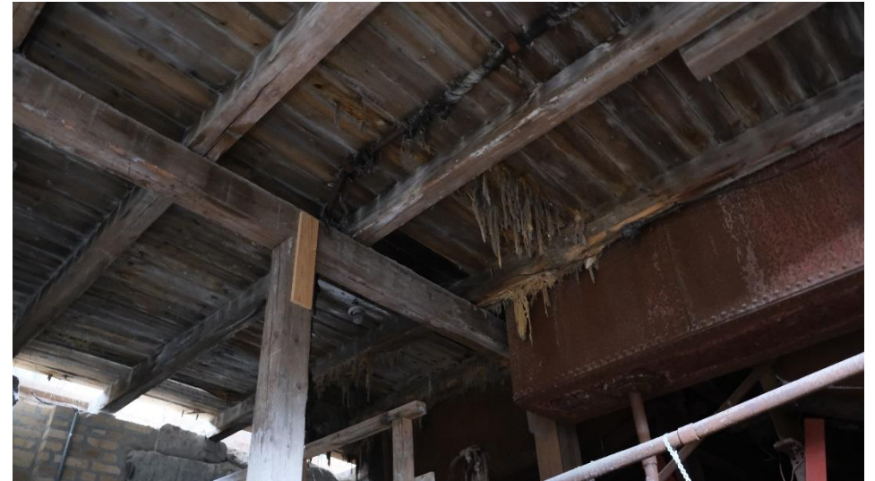
Skader i golv i vestre del av kjelleren.
