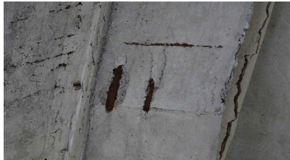
Detalj i tak i maskinhallen, ett av flere små felt med synlig armeringsstål som rustet, betong sprekker opp og løsner. Skadeomfanget øker.
