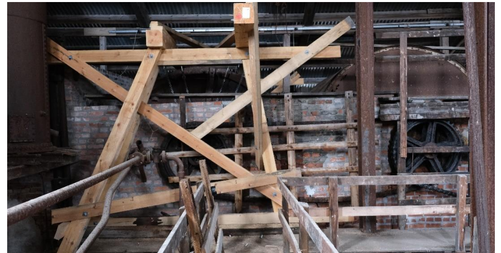
Ett varpeaggregat som er hengt opp i ny sikringskonstruksjon. Det er nødvendig å sikre de to resterende aggregatene innen kort tid.
