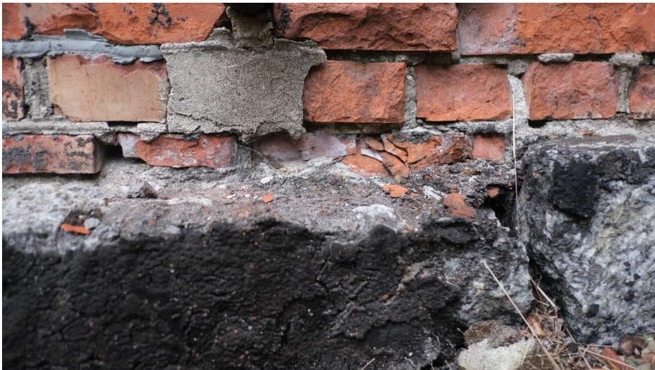
Fra østre del av sørvegg, betydelige forvitringsskader i tre skift ved grunnmur.
