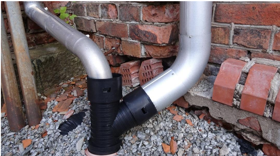
Ved hjørne mot nordvest, med gamle og nye forvitringsskader i tegl og fuger. I nymurt smitegl (2012) på bildet og videre sørover er det allerede dype skader i fuger.
