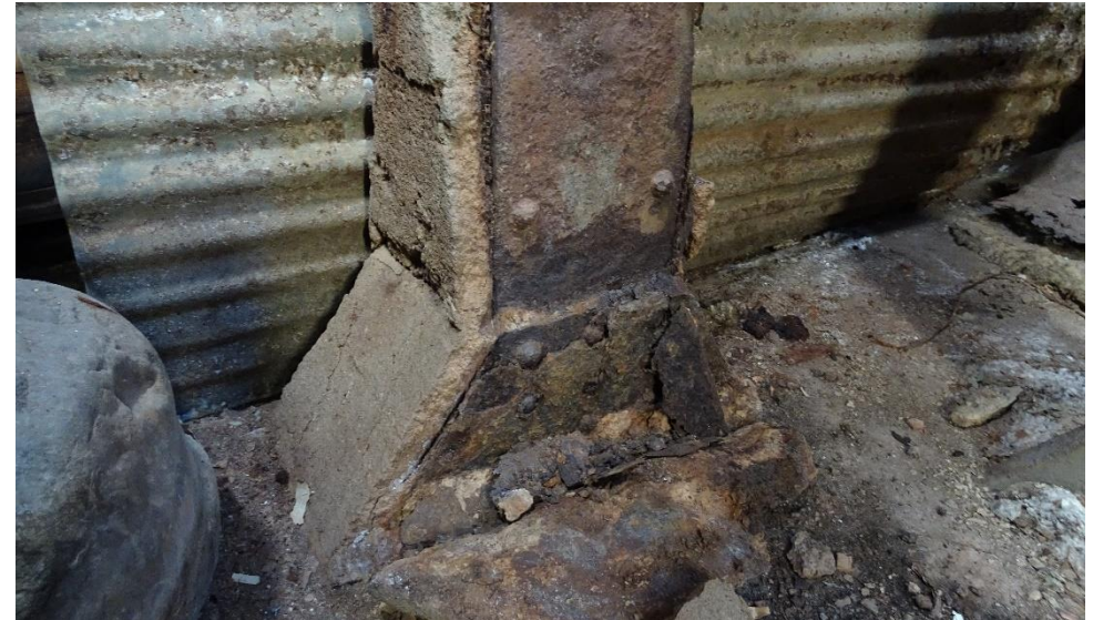
Betydelige korrosjonsskader i sko og nederste del av stålsøyle som står på golvet i kjelleren. Korrosjonen har sprengt i stykker betongen på utsiden.
