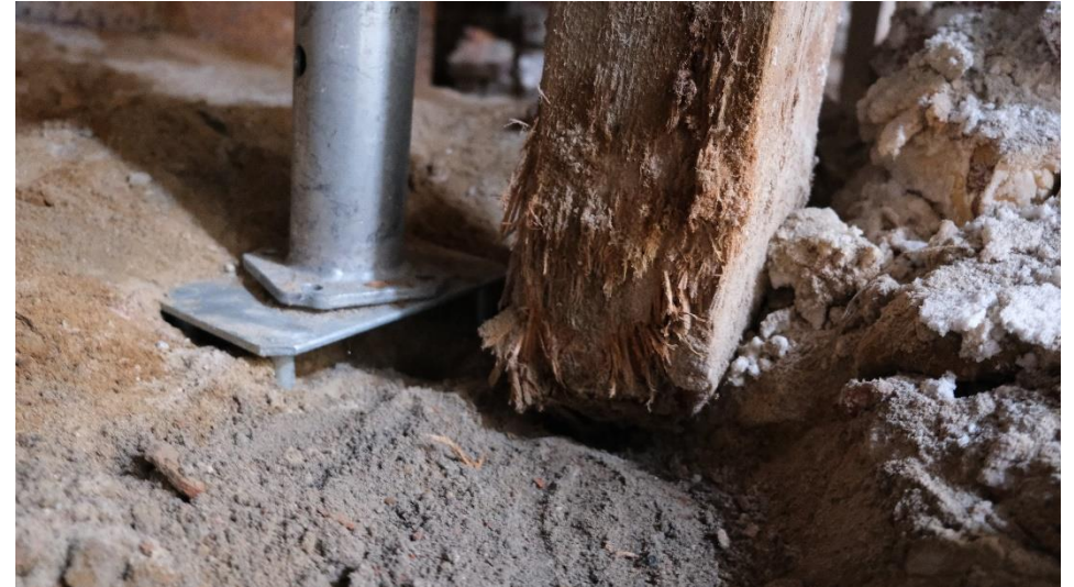
Bærepunkt i kjelleren som er sikret med et stålstag ettet brudd i betongfundament og råte nederst i trestolpe.
