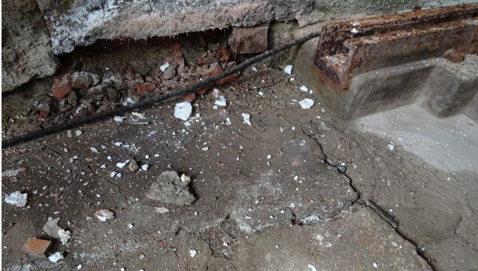
Slam på golvet i motorrommet nær vegg til Luthuset (11.9.2020), etter kraftig regnvær. Vann og finkornet jord har trukket gjennom fundament eller grunnmur.
