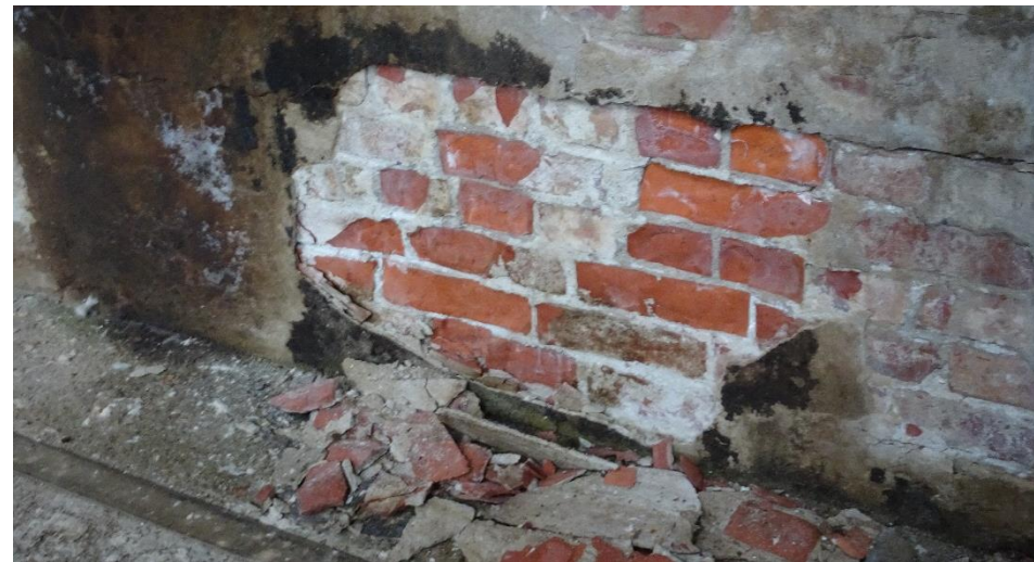
Skader etter salt- og frostforvitring i teglfundament for papirmaskinen. Ekstra store skader fordi det er pusset med "tett" sementmørtel eller en sterk kc-mørtel.
