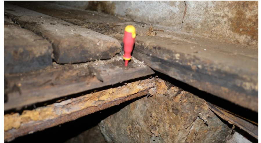
Råteskader i plankedekke i nordøstre del av Turbinhallen, samt rustflak i flere sjikt i stålbjelke.
