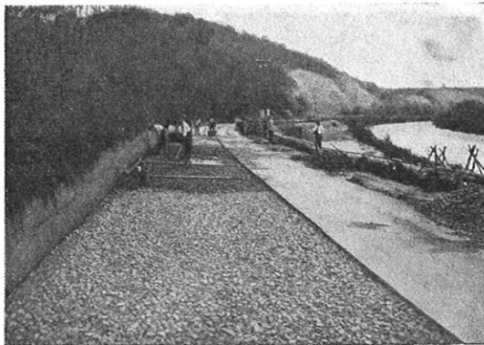
Fig. 4. Dette sement-pukk-dekket på vegen Münster—Mühlhaus blir bygt i to teigar. Den fyrste teigen, høgre veghalva, er ferdig. Den andre teigen, vinstre veghalva er her i arbeid. Nærmast ser vi nedste pukklaget. Lenger burte legg dei andre pukklaget ovanpå mørtellaget. Burtanfor der att held dei på med valsing og tetting av vegdekket.
