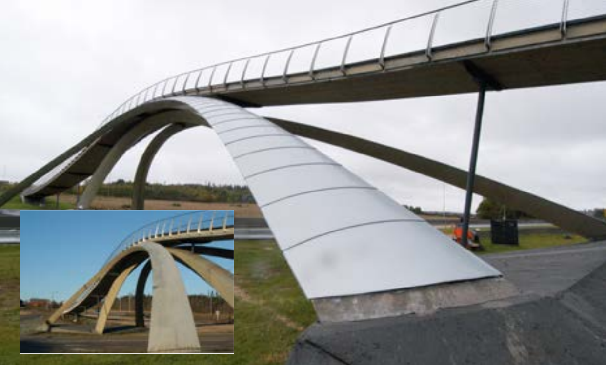
Leonardo da Vinci gangvegbru ble bygget i 2001 over E18 i Ås. Det innfelte bildet er fra 2005. Allerede da så man tegn på soppskader, og buene ble beskyttet av sinkplater i 2008. (Foto: Håkon Aurlien)
